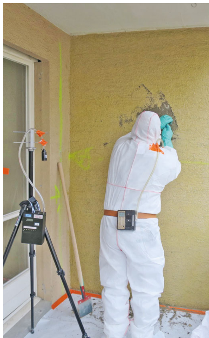
Échantillon d'air stationnaire et ambulatoire lors de l'enlèvement d'un enduit de façade.
