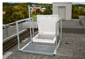
3 Sicherer Zugang zu hoch gelegenen Maschinenraum
