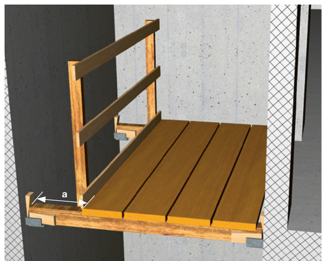
6 Una protezione laterale a tre elementi impedisce la caduta dall'alto se la distanza [a] è maggiore di 30 cm.
