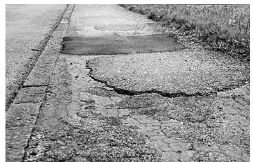
3 Mangelhaft ausgebesserter Belag. Niveaudifferenzen sind möglichst klein zu halten.
