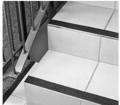
2 Nachträglich angebrachte Gleitschutzstreifen auf einer glatten Steintreppe.
