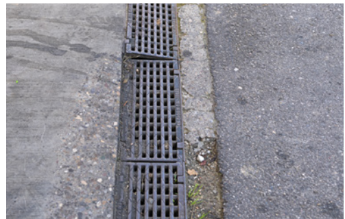
4 Absenkungen im Bodenbelag führen zu einer Stolper- und Sturzgefahr
