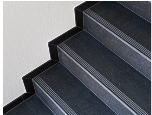
2 Sichtbare Anti-Rutschmassnahmen auf einer Treppe
