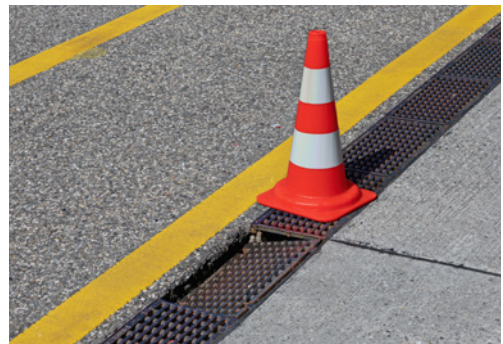
3 Defekte Rinne mit gut sichtbarer Pylone gekennzeichnet
