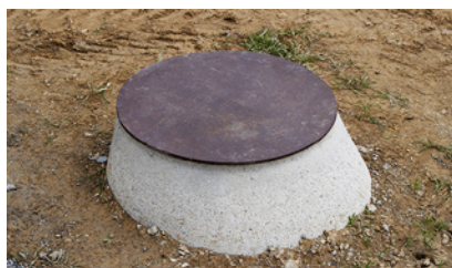
2 Tombino chiuso con copertura in ferro
