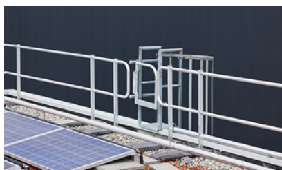
2 Protezione laterale sul piano di arrivo
