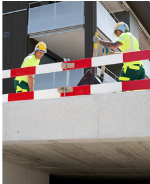
Regola 4 Mettere in sicurezza le zone con rischio di caduta a partire da un'altezza di caduta di 2 m
