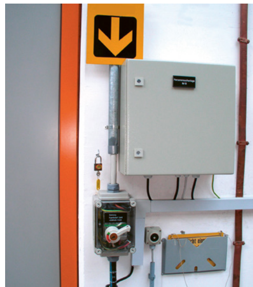
5 Interruttore generale della gru che può essere disinserito e messo in sicurezza contro l'avviamento accidentalmente con un lucchetto.
