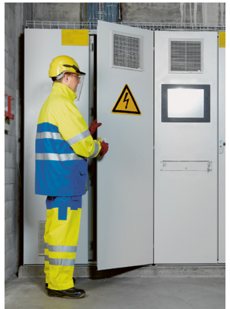
6 Die Zugangsberechtigung zum Schaltschrank ist geregelt.
