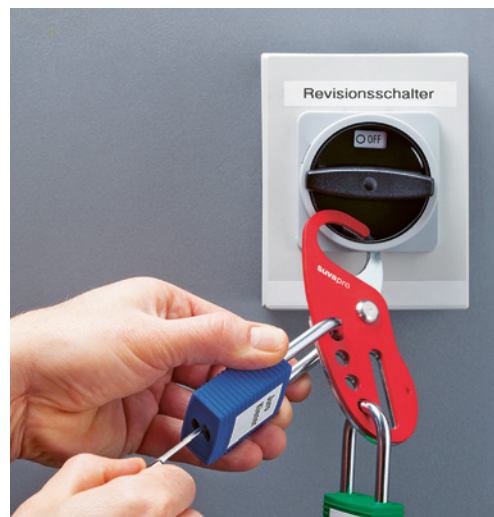
3 Revisionschalter, gesichert mit persönlichen Vorhängeschlössern und Mehrfachschiessbügel
