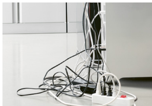
4 Steckdosen so anbringen, dass die Kabel nicht zur Stolperfalle werden.
