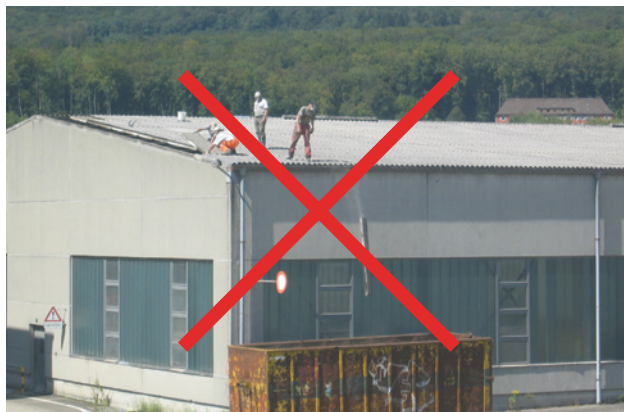
1 und 2 Grobfahrlässiges Verhalten beim Arbeiten auf Faserzementdächern und im Bereich von Lichtplatten
