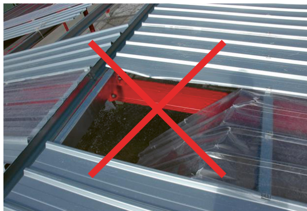
3 Ein Einsturz durch eine Lichtplatte muss verhindert werden.
