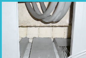
Barriera antifiamma con cuscini di amianto
