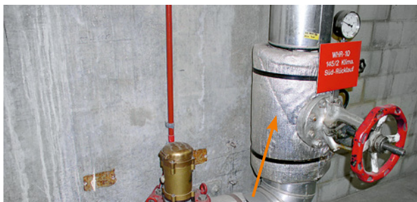
Materassini isolanti contenenti amianto
