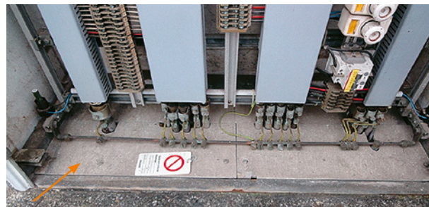
... nei quadri di distribuzione
