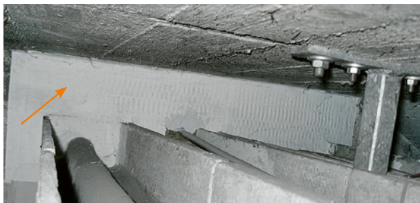
Passaggio cavi in una sigillatura antincendio
