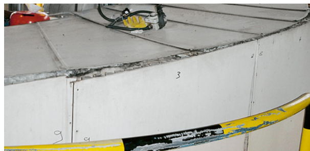
Isolamento contenente amianto dietro un rivestimento
