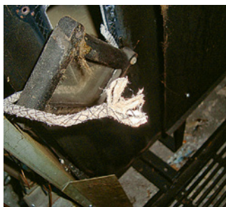
Cordone di amianto
