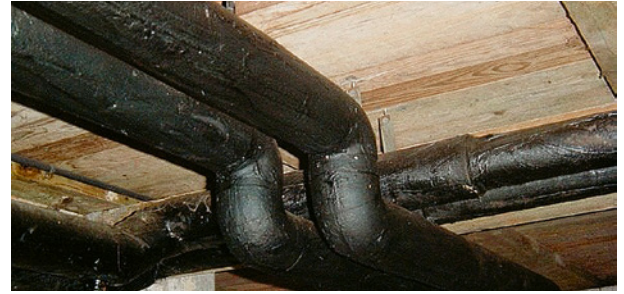
Guaina bituminosa contenente amianto
