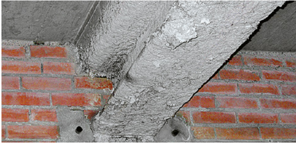
Amianto spruzzato su travi di acciaio
