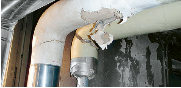
Tubo con malta contenente amianto
