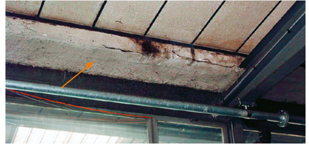
Isolamenti di amianto spruzzato sulla copertura
