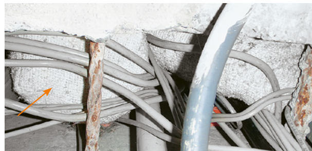
Cuscini di amianto
