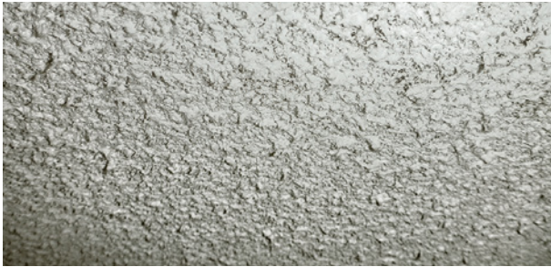
Intonaco fonoassorbente contenente amianto
