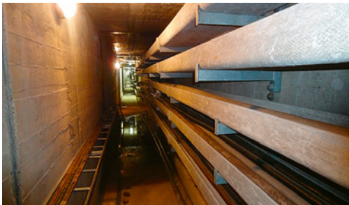
Canalette per cavi
