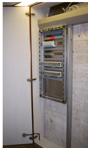
1 Panneaux légers contenant de l'amiante utilisés par ex. comme revêtements de protection incendie pour une armoire électrique (ici, garniture de porte).
