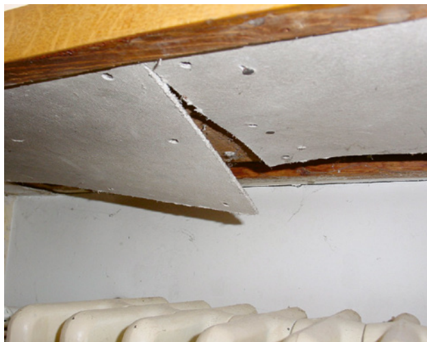
3 Panneaux légers contenant de l'amiante utilisés comme revêtements de protection incendie, par ex. pour les radiateurs.
