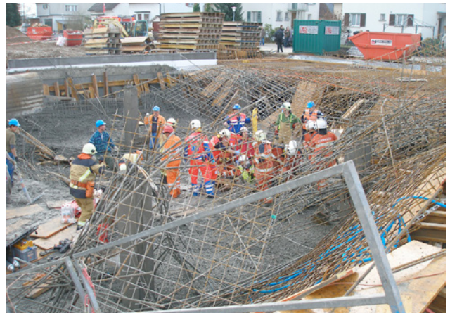
6 Effondrement du coffrage (armature incluse) sous l'effet des forces excentrées.
