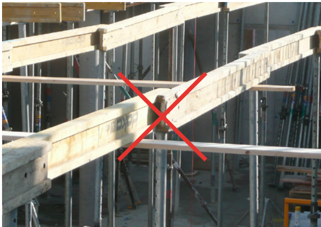
5 Étayage pour éléments en béton préfabriqués: manque de stabilité, étais inclinés, absence de têtes à fourche à la jonction des poutrelles.
