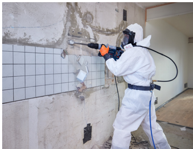
1 Misure di protezione indicate nella direttiva CFSL 6503 «Amianto»
