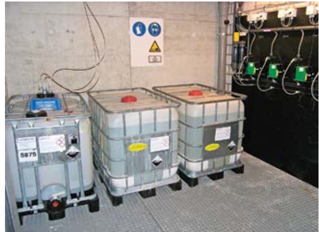
Bild 3 Blick in den abgetrennten Raum für die Säuredosierung. Der Fussboden ist als Auffangwanne gestaltet; in der Ecke Abluftkanal der künstlichen Raumentlüftung.
