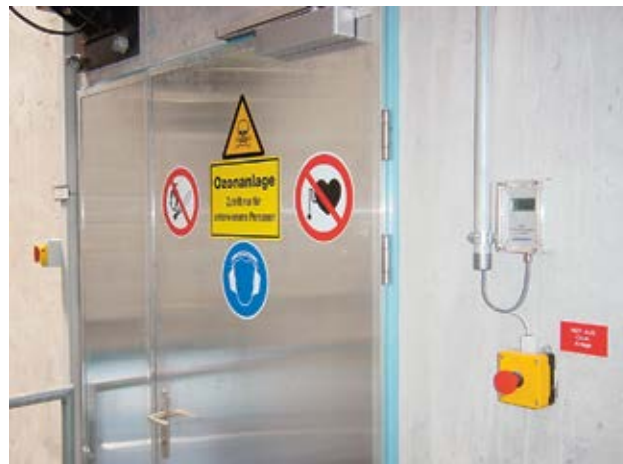
Bild 2 Not-Aus-Taster ausserhalb des Aufstellungsraumes des Ozonerzeugers
