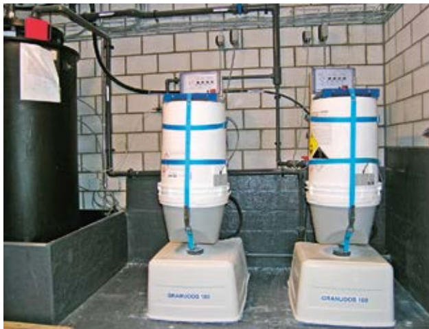
Bild 1 Dosierstation für Calciumhypochlorit. Damit kann auf das Lagern und den Einsatz von Chlor in Druckbehältern verzichtet werden.
