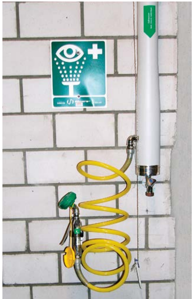
Bild 4 Einrichtung für die Erste Hilfe im Säureraum.
