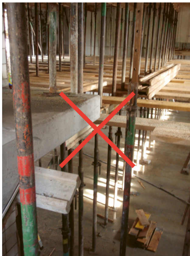
1 Ce type de plancher intermédiaire est interdit. Les travaux doivent être stoppés.
