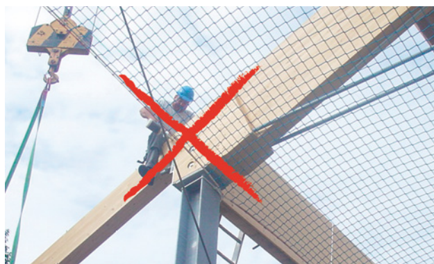
6 Rete di sicurezza inefficace con una sporgenza insufficiente rispetto al bordo di caduta
