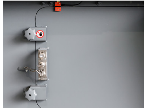
4 Zugangstüre mit Endschalter und Schlüsseltransfersystem. Dies verhindert, dass Dritte die Maschine wieder anlaufen lassen können.
