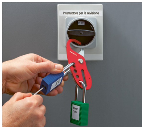
1 Interruttore per la revisione bloccato con lucchetto e dispositivo di chiusura multipla
