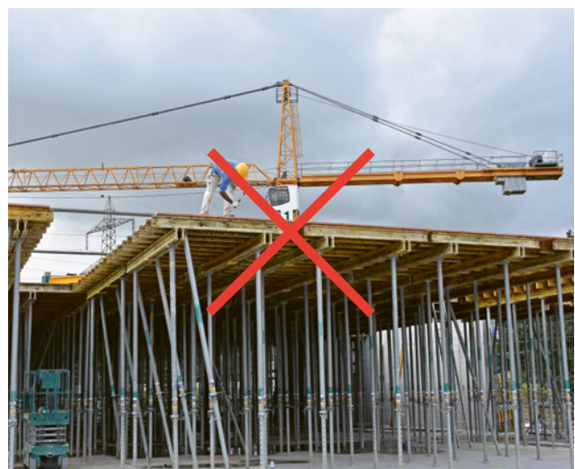
2 Verboten: Deckenschalung ohne Absturzsicherung bei Absturzhöhen über 2 m.
