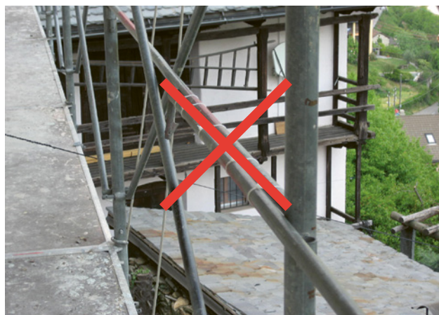
3 Le fascette serracavo sono vietate in quanto non sono abbastanza solide.
