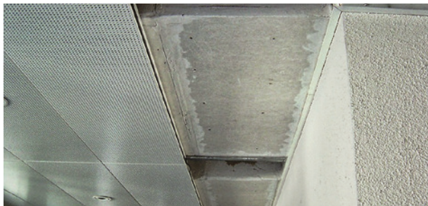
Plaques de faux plafonds amiantées
