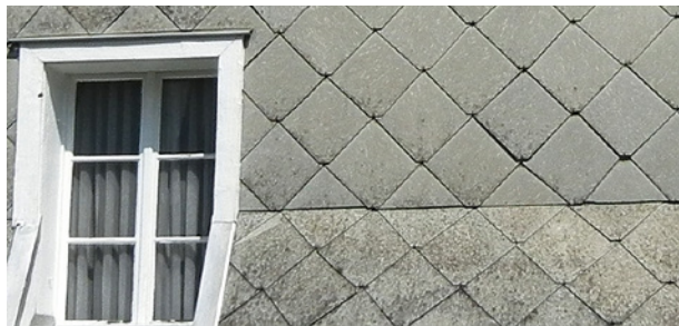
Plaques de façade amiantées
