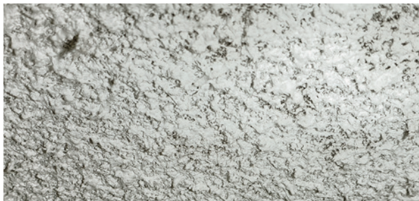
Crépi acoustique amianté
