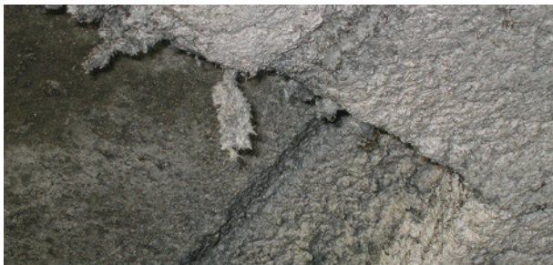
Amiante floqué sur une poutre métallique
