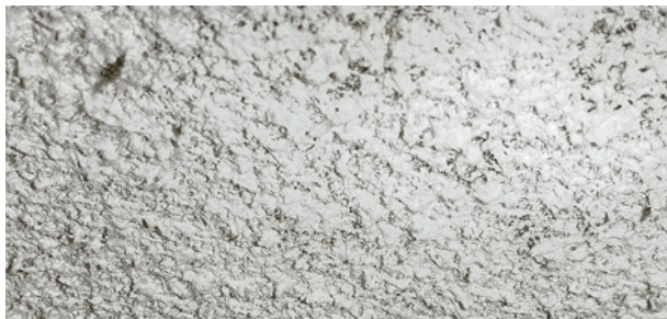
Crépi acoustique amianté
