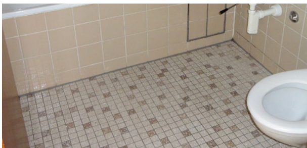
Carrelages et faïences avec colle amiantée
