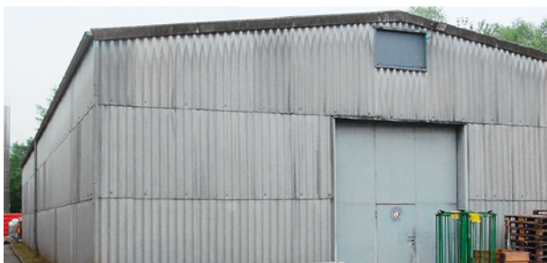
Plaques ondulées amiantées
