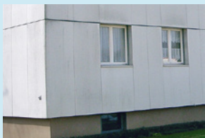
Plaques de façade amiantés
