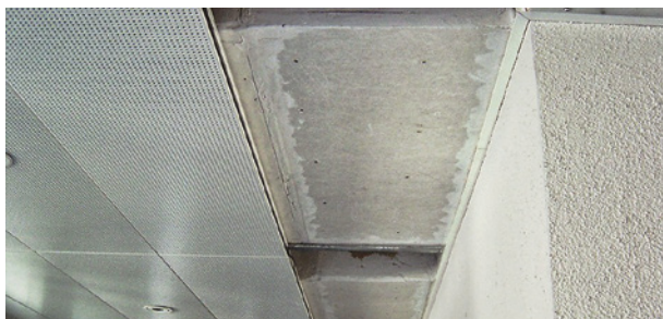
Plaques de faux plafonds amiantées
