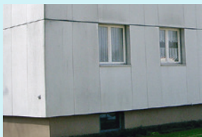
Plaques de façade amiantés
