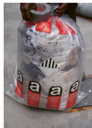
4 Sac en plastique avec marquage «Amiante»
