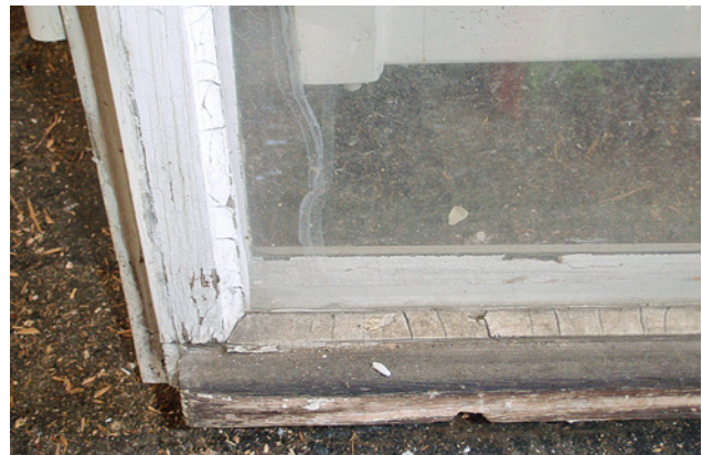
1 Mastic à l'huile de lin amianté d'une fenêtre en bois.
