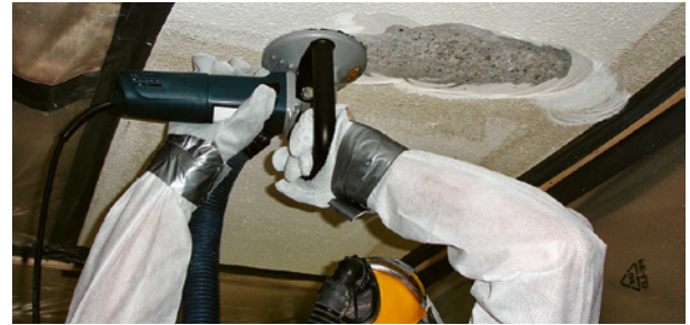
Entfernen nur durch ein anerkanntes Asbestsanierungsunternehmen
