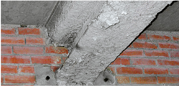
Spritzasbest an Stahlträger
