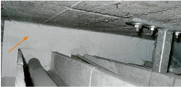
Kabeldurchbruch mit Brandabschottung
