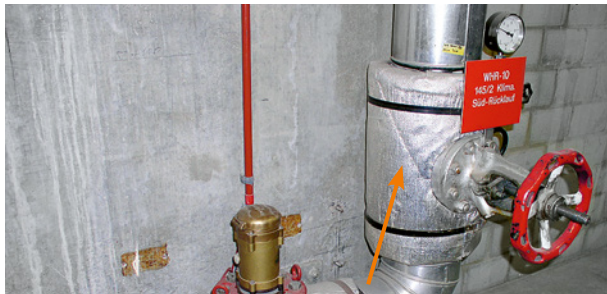
Isolationsschale für die Hitzeisolation
