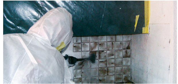
Entfernen nur durch ein anerkanntes Asbestsanierungsunternehmen
