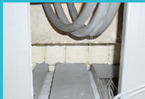
Brandabschottung mit Asbestkissen
