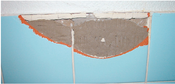
< 1 % Chrysotil-Asbest im Kleber
