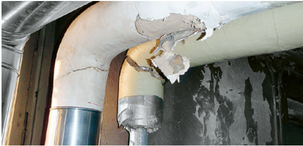
Rohrleitung mit asbesthaltigem Mörtel
