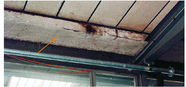
Spritzasbestisolation an Dachkonstruktion
