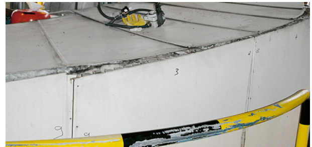
Asbesthaltige Dämmung hinter einer Verkleidung
