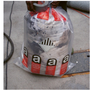
6 Sacco di plastica con la dicitura «Amianto»
