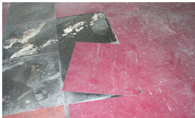
1 Con i rivestimenti monostrato floorflex (duri e friabili) l'amianto è saldamente inglobato nella plastica.
