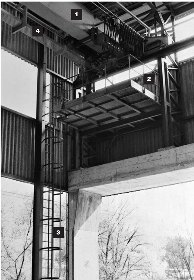
16 Einträgerkran mit Unterflanschlaufkatze. Zur Wartung der Unterflanschlaufkatze und des Hubwerks ist am Gebäude ein Podest angebaut. Von diesem aus können alle zu wartenden Teile erreicht werden. Der Abstand zwischen untersten festen Teilen an der Unterflanschlaufkatze und dem 1,1 m* hohen Geländer beträgt 0,5 m. Der Aufstieg auf das Podest erfolgt über eine Leiter mit Rückenschutz.
