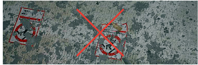
5 Les autocollants ne constituent pas une mesure de protection contre les chutes.
