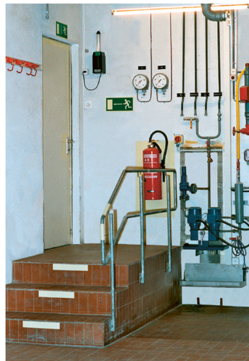
4 Exemple de fléchage avec bandes phosphorescentes (situation de jour).
