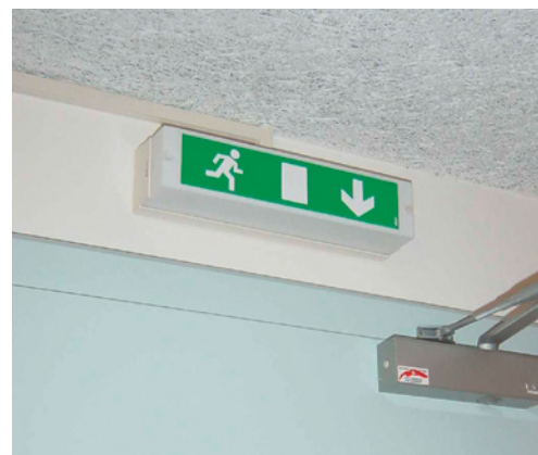
6 Exemple d'éclairage de secours.
