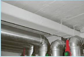
Canalina per cavi in fibrocemento
