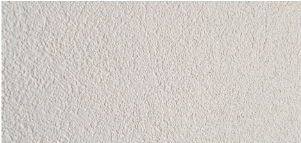
Intonaco fonoassorbente contenente amianto
