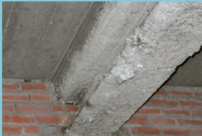
Isolamento in amianto spruzzato
