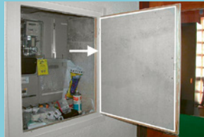
Pannello antincendio contenente amianto
