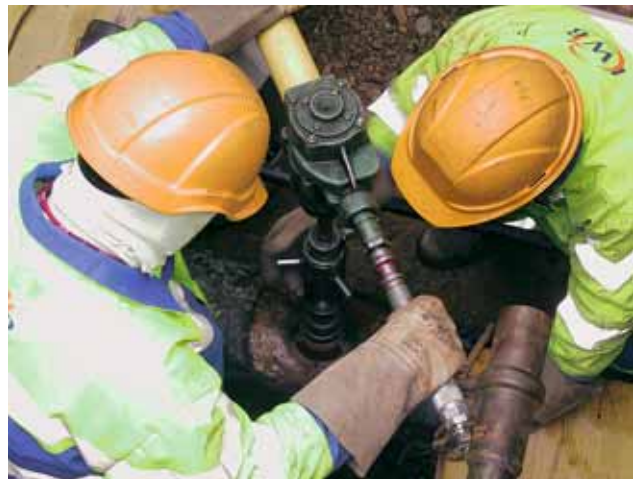
Fig. 19: intervention sur un piquage d'obturation d'une conduite en acier au moyen d'une perceuse à air comprimé.
