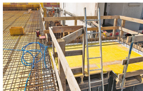
8 Die Leiter ragt mindestens 1 m über die Ausstiegskante, ein sicherer Überstieg mit Geländern ist sichergestellt.
