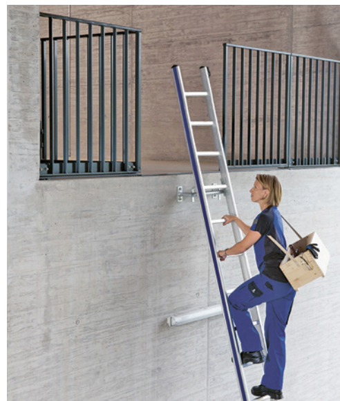
7 Leiter sicher besteigen: Blick zur Leiter, gutes Schuhwerk, mit beiden Händen sicher festhalten, Material in Transportkiste.
