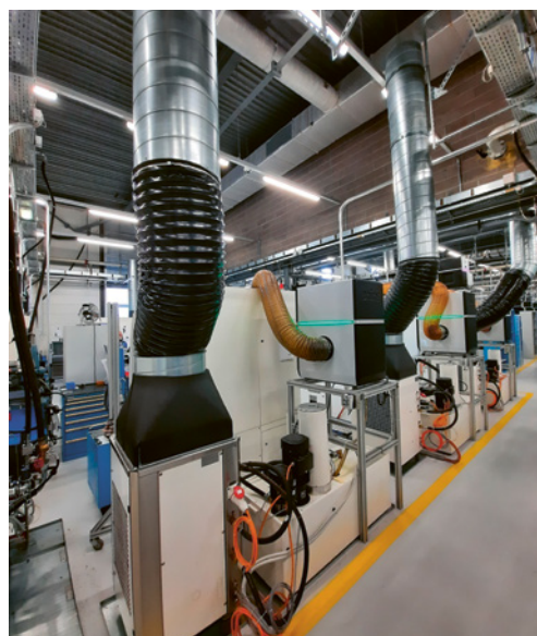
3 Sistema di aspirazione che permette di depurare l'aria dagli oli e di reimmetterla nel locale oppure di evacuarla all'esterno.
