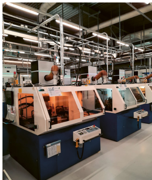
1 Officina di décolletage provvista di ventilazione artificiale. Una volta filtrata, l'aria viene reimessa nella zona di lavoro.
