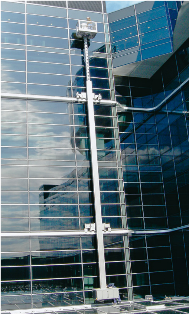
13 Mastbefahranlage mit Arbeitskorb auf vertikalem Teleskopmast für das Reinigen der Gebäudeverglasungen.
