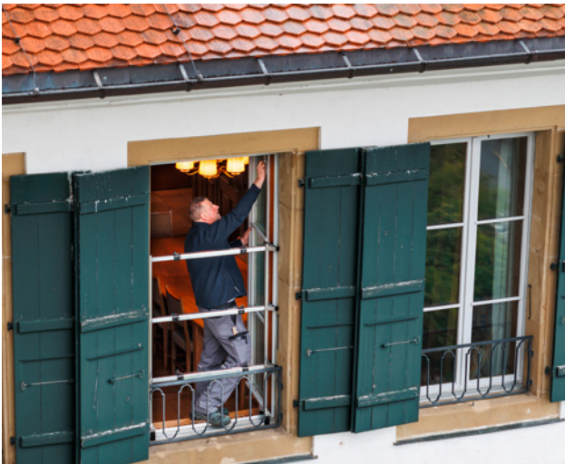
19 Die Fenstersicherung ermöglicht es der Person, die auf dem Fenstersims steht, sicher zu arbeiten.
