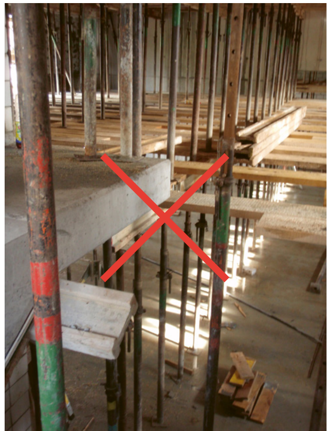
1 Questo tipo di piano intermedio è vietato e comporta la sospensione dei lavori.
