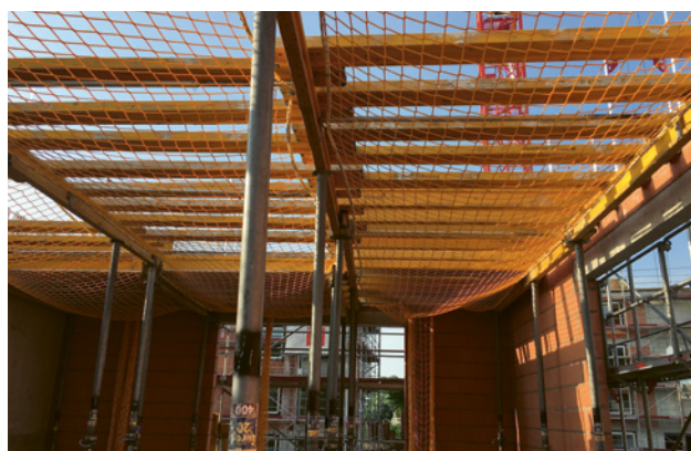
4 Coffrage conventionnel avec protection collective (filets de sécurité) dont la conformité a été certifiée.
