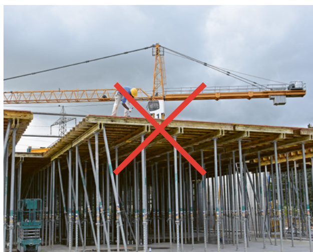
2 Interdit: coffrage de dalle dépourvu de protection antichute et d'accès sécurisés.
