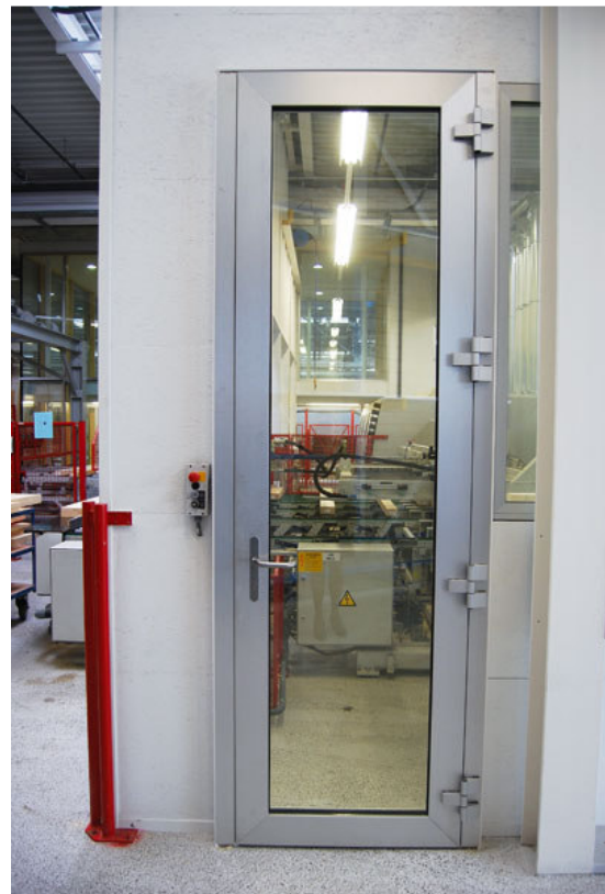
Die Gefahrenbereiche der Fensterproduktionsanlage sind mehrfach abgesichert, unter anderem durch eine Tür mit Zuhalteverriegelung.
