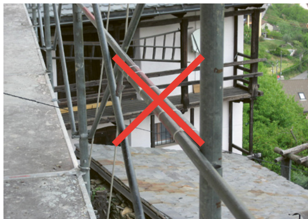
3 Kabelbinder sind nicht erlaubt. Sie sind nicht genügend fest und deshalb verboten.
