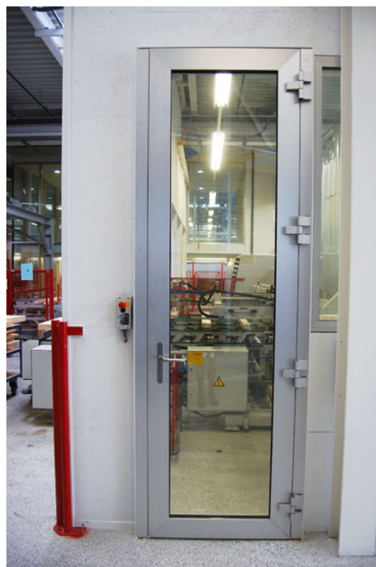
Le zone pericolose della linea di produzione sono rese sicure a più livelli, anche con una porta dotata di blocco con meccanismo di ritenuta.
