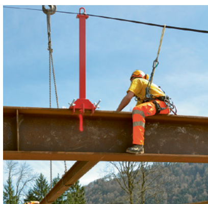
2 Linea vita temporanea con montanti per un sistema di ancoraggio continuo.
