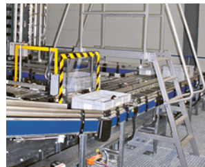
3 Übergangsbrücke über Rollenbahn
