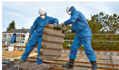
1 Bei Rückbauarbeiten Faserzementplatten nicht bearbeiten.
