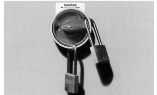
Bild 10: Sicherheitsschalter. Damit während Instandhaltungsarbeiten die Bänder von Dritten nicht in Betrieb gesetzt werden können, sind die Sicherheitsschalter mit persönlichen Vorhängeschlössern abzuschließen.
