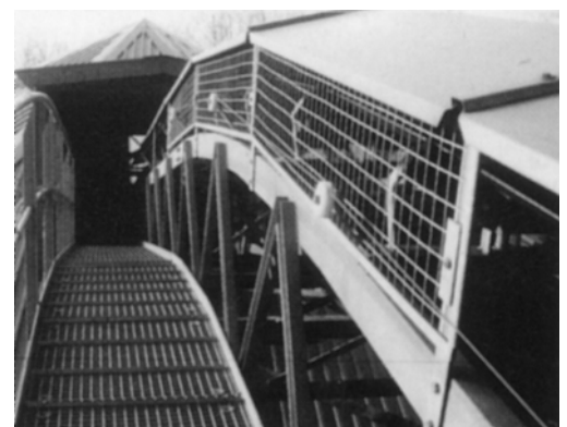
Bild 6: Schutz im Durchgangsbereich mit verschraubtem Maschengitter an einem geknickten Band. Das Vergitterungsende muss über die Einzugsstellen hinausragen!
