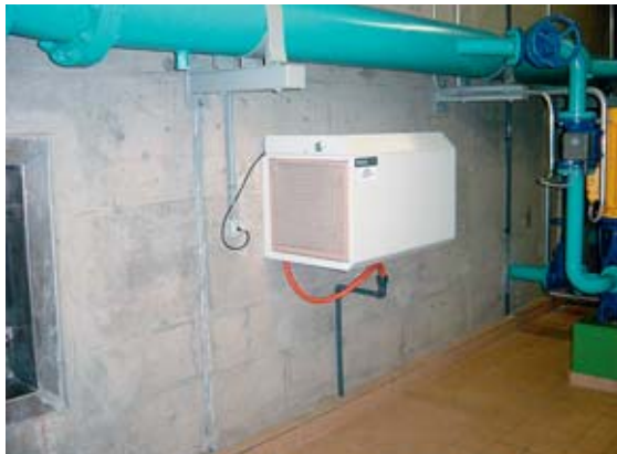
2 Déshumidificateur avec un filtre sur lequel les produits de désintégration du radon peuvent s'accumuler.
