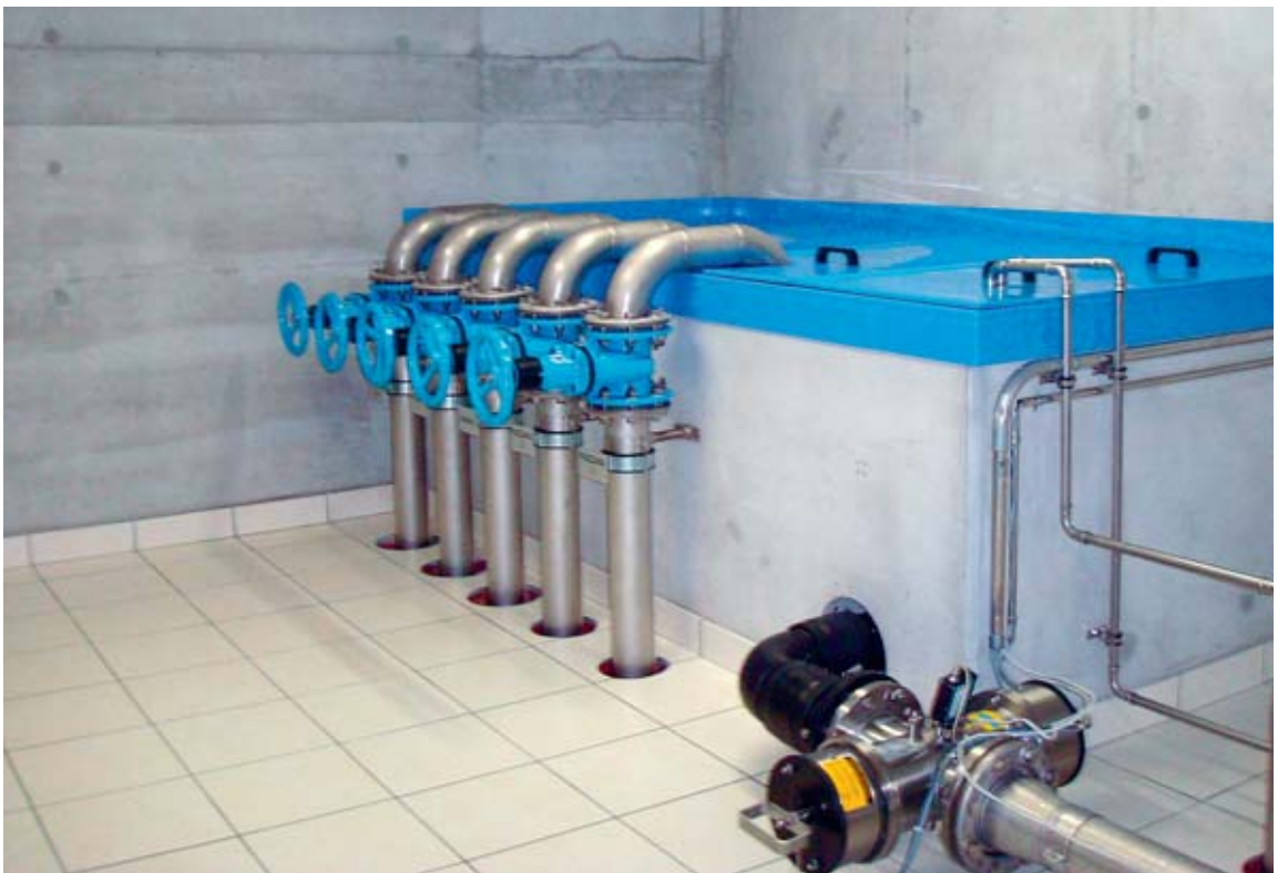
4 et 5 Le radon est dégazé de l'eau avec des équipements spéciaux.
