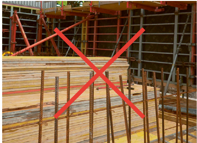
1 Fers d'armature en attente non sécurisés
