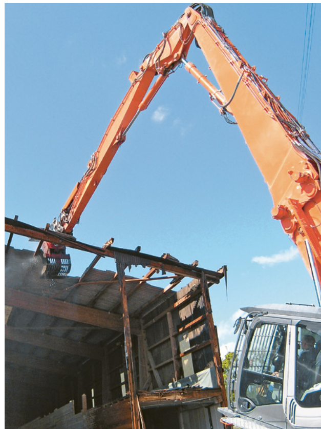
Plaques ondulées amiantées
