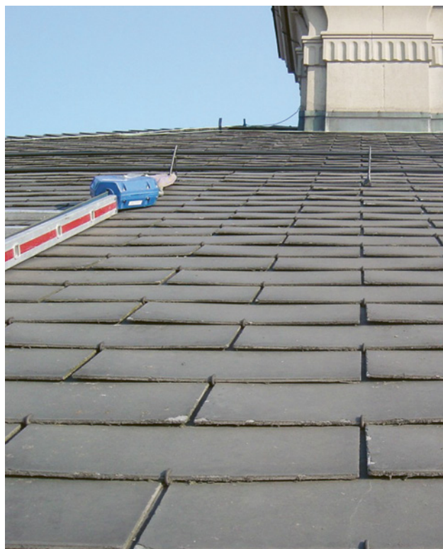
Ardoises en fibrociment amianté
