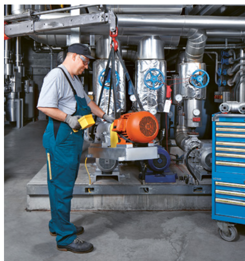
2 Opérateur de maintenance utilisant le palan prescrit comme moyen auxiliaire.
