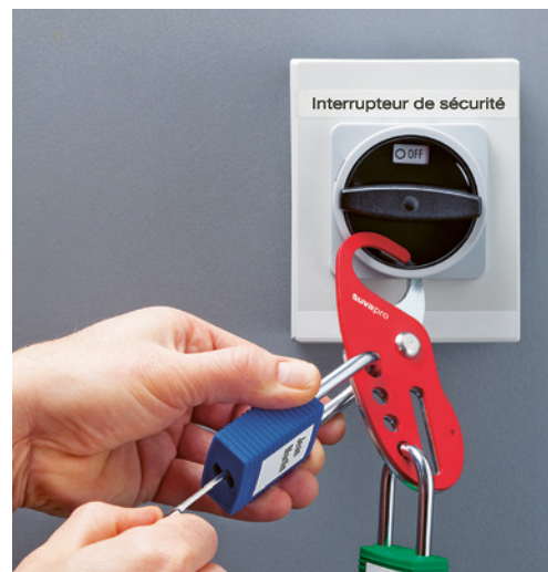
3 Interrupteur de sécurité verrouillé avec des cadenas et un morillon de consignation.
