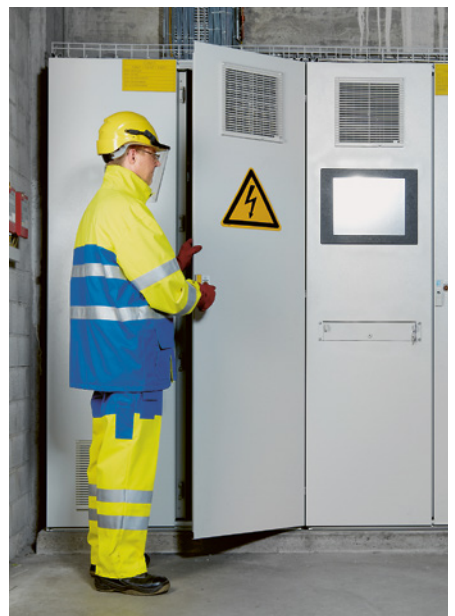
6 Réglementation des droits d'accès à l'armoire de commande.
