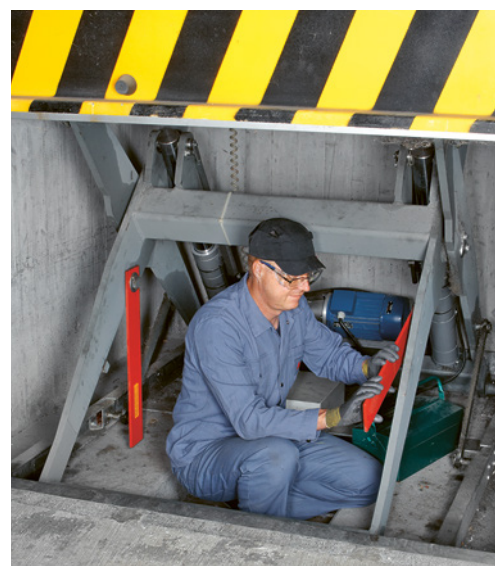
4 Cales servant à sécuriser une plateforme élévatrice.
