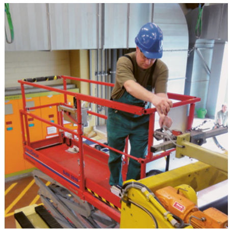
5 Travaux de graissage en hauteur depuis une plateforme élévatrice mobile de personnel.
