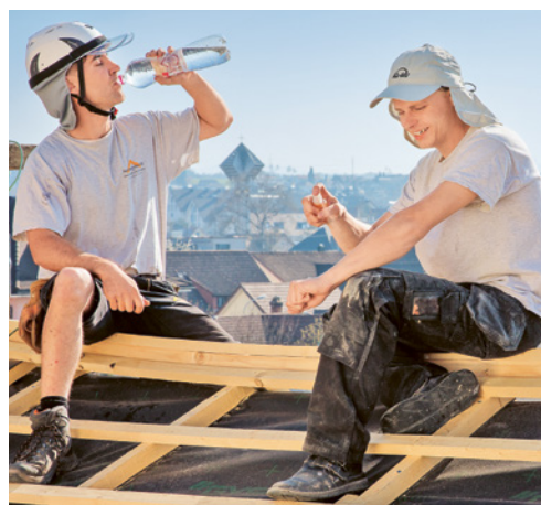
2 Il corpo deve essere interamente schermato dai raggi solari (raggi UV).
