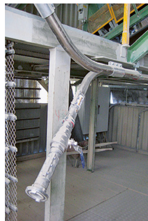
3 Impianto centrale di aspirazione delle polveri
