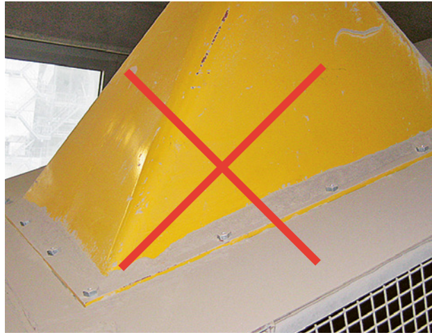
5 Accumulo di polveri: manutenzione insufficiente
