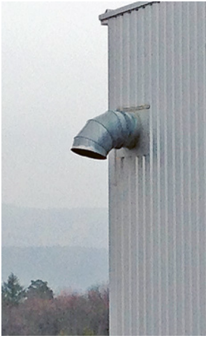
4 Aria in uscita da un depolverizzatore convogliata all'esterno
