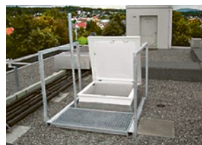
3 Accès au local des machines en hauteur
