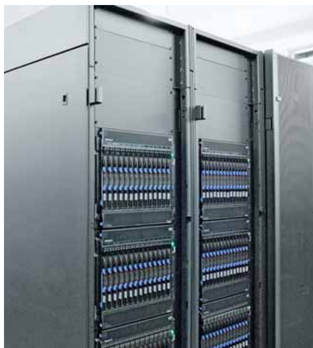
2 Dans les locaux de serveurs, une atmosphère appauvrie en oxygène offre une protection accrue contre les incendies.
